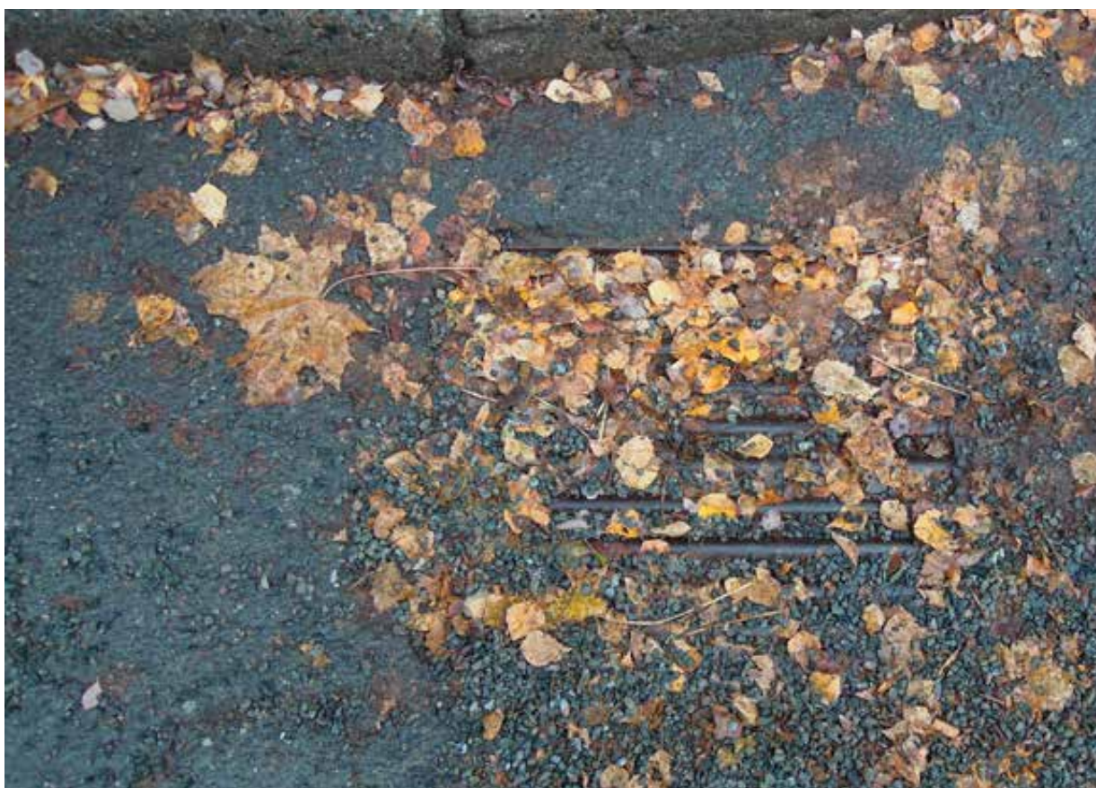
Sandfanget er fullt og risten er tett. Vegene må feies, sluk og rister må rengjøres og sandfangene må tømmes. Foto: Christen Ræstad
