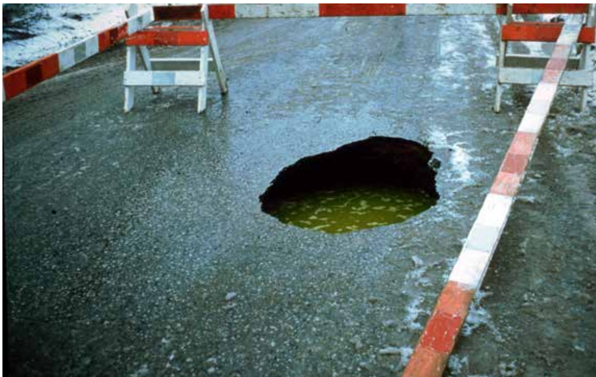
Sammenbrudd i avløpsledningen ødelegger vegen. Foto: Christen Ræstad
